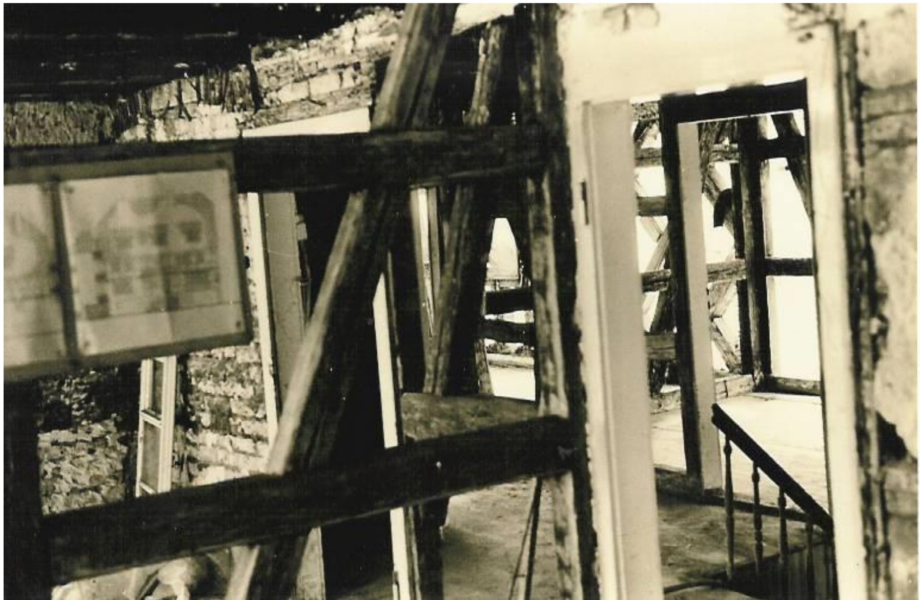
Im 1. Stockwerk, vom späteren Frankenzimmer gesehen, mit alter Treppe nach unten. Plan an der ausgebeinten Wand zum späteren Biedermeier-Zimmer.
