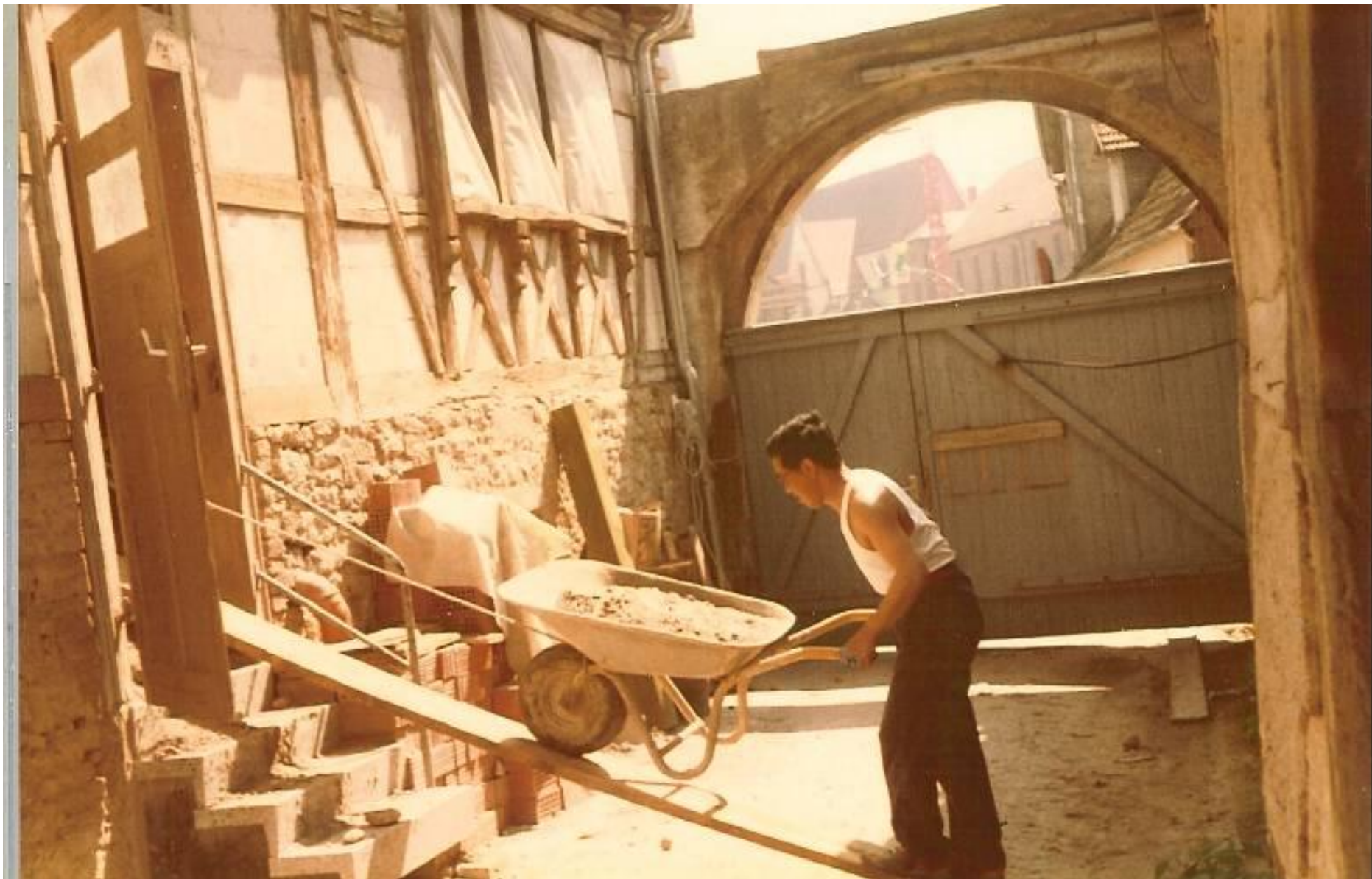
(Aufbauarbeit wie in VR-China) Langsam rückwärts gehen, um den Schutt nach außen zu bringen.
